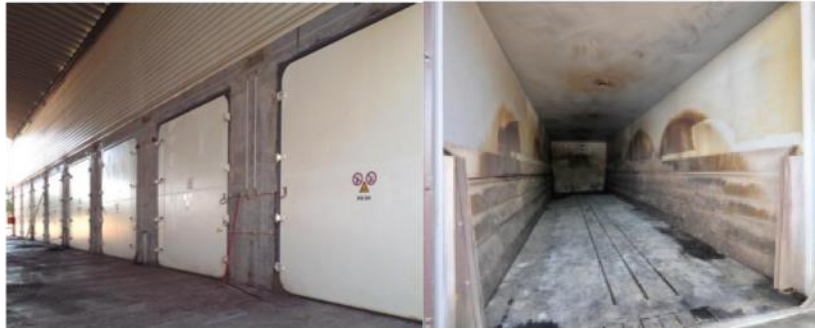
Figura 26. Portas dos túneis de metanização (à esquerda) e interior do túnel (à direita).
