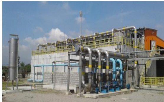
Figura 27. Detalhes tubulações de biogás e exaustão.
